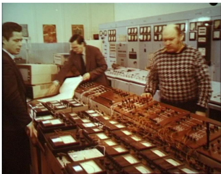
Щит управления электродинамической моделью энергосистемы.
