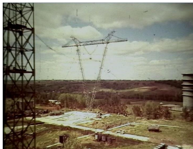
Опытный пролет ЛЭП 1150 кВ. на испытательном стенде СибНИИЭ
