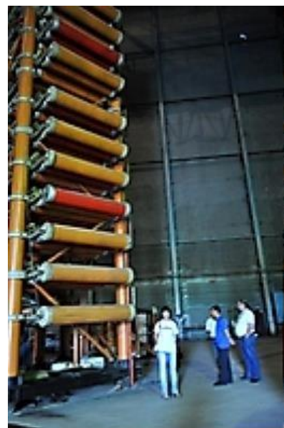
Генератор импульсного напряжения 4,8 МВ внутри в/в зала
