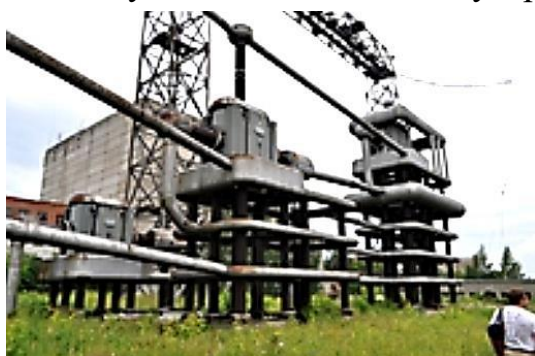
Первый каскад испытательных трансформаторов 3 х 750 кВ фирмы TUR (Германия)
