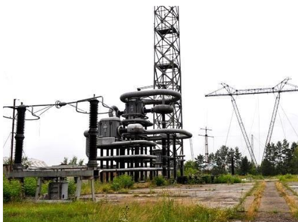
Второй каскад испытательных трансформаторов на ВИКе СибНИИЭ. Первая наружная площадка.
